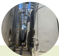
CUVERIE EXTÉRIEURE / THERMO 2017 - Romagne
